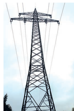
Strommast für Verteilnetz
